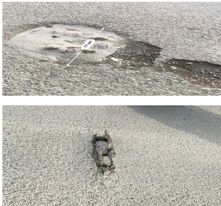
Gambar 2. Kerusakan Jalan Jenis Lubang
