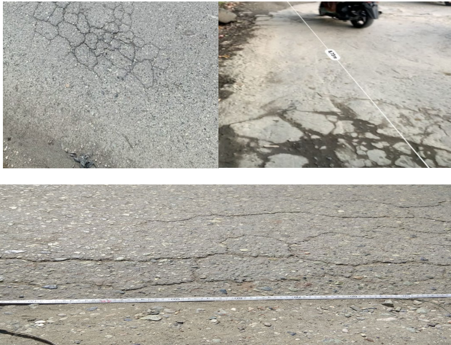
Gambar 3. Retak Samping Jalan (pinggir)
